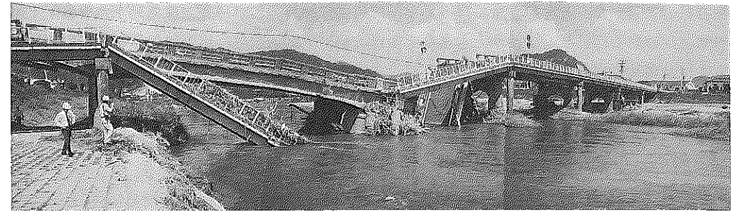
写真12 天降川日当山橋の被災状況
